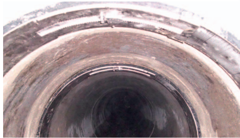
In der Lent Kaserne in Rotenburg/Wümme wurden Schäden im Muffenbereich eines Betonkanals DN 1000 mit Edelstahlmanschetten saniert.
