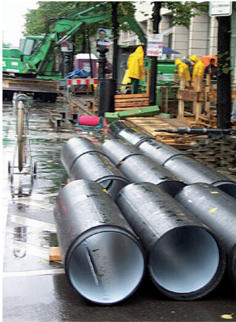
Vorbereitete Kurzrohre DA 560 kurz vor dem Einbau. Bauvorhaben: Berlin, Unter den Linden.
