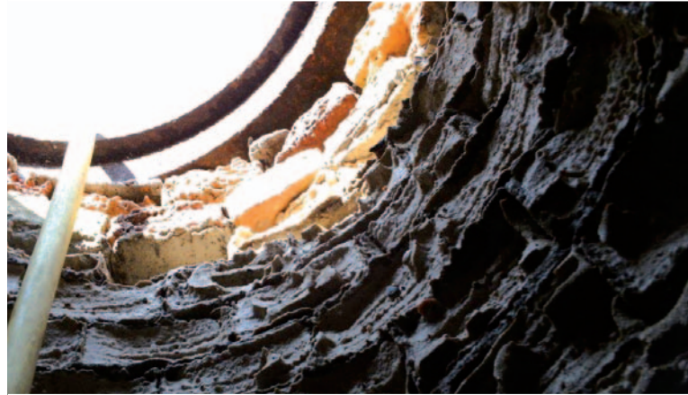
Korrosionsgeschädigter, gemauerter Schachtkonus nach dem Reinigen.
