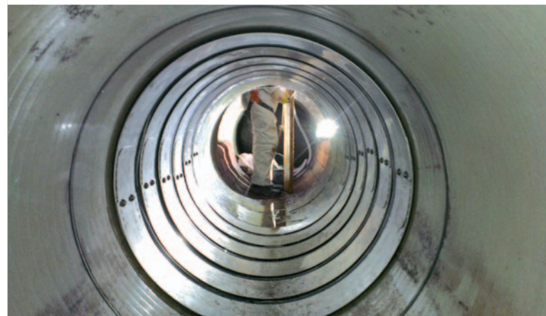
Schadhafte GFK-Auskleidung am Verbundvortriebsrohr Beton/GFK DN 1000 Schmutzwasser.
